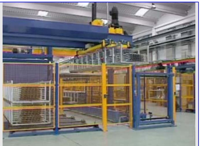
Fig. 6: Transportador automático con cestas llenas
