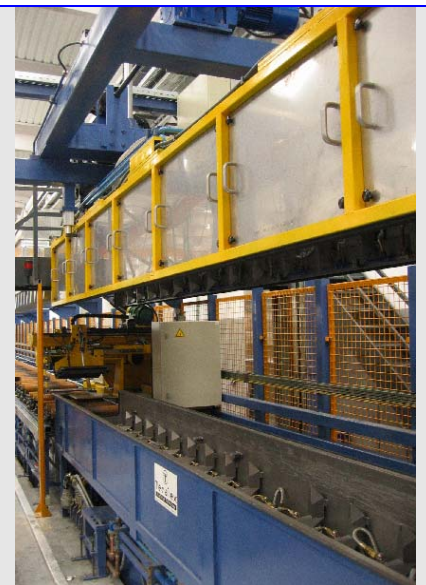
Abb. 3) Kühlanlage für eine 2200 MT Strangpresse
